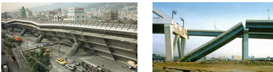
Рис.1. Разрушение транспортной эстакады во время землетрясения в Кобе (Япония)
